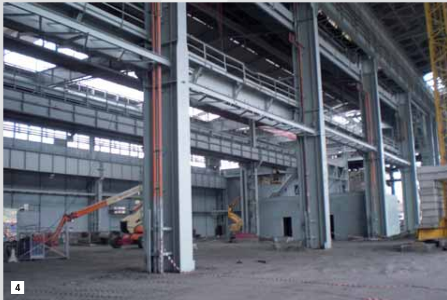
4 Colorificio Camerini ha anche fornito il prodotto verniciante per il rivestimento delle tubature di trasporto di liquidi e gas in colori diversi in modo da facilitarne l'identificazione.
